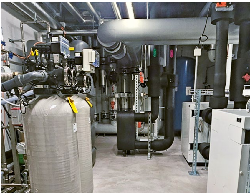
Verteilerzentrale Borna Arbeits- und Wohngemeinschaft
